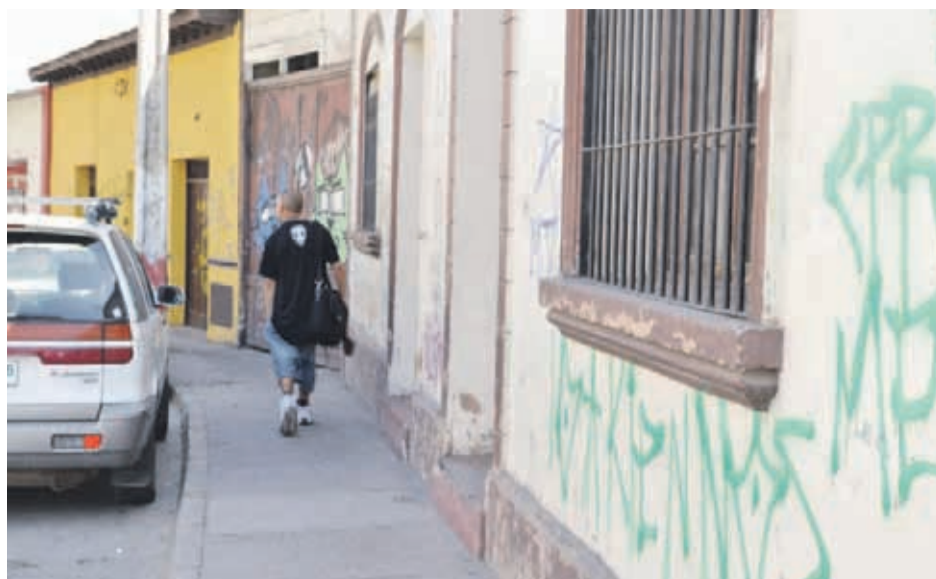
Los rayados o grafitis se han transformado en un problema permanente y significan un alto costo para el municipio poder eliminarlos.
