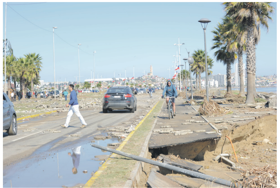
OLAS DEVASTADORAS. La fuerza del agua dañó el pavimento de la Avenida Costanera destruyendo ciclovías. Quedó demostrada la importancia de evacuar la zona costera.
