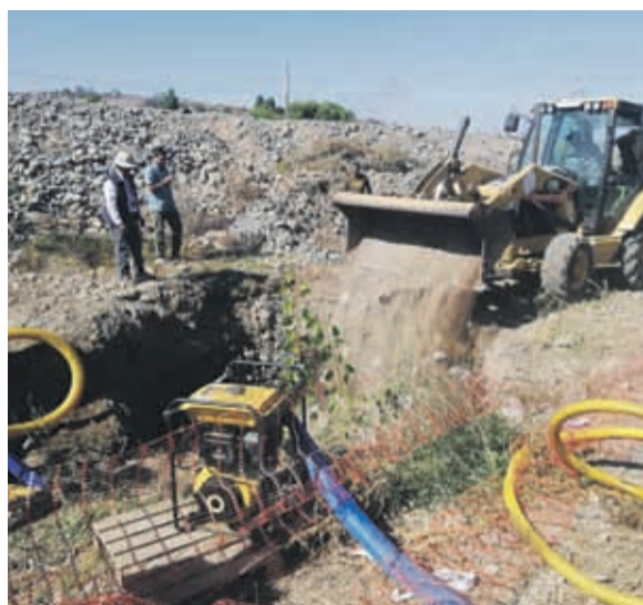
EL sistema cuenta con una bomba de 500 a 650 litros de capacidad.
