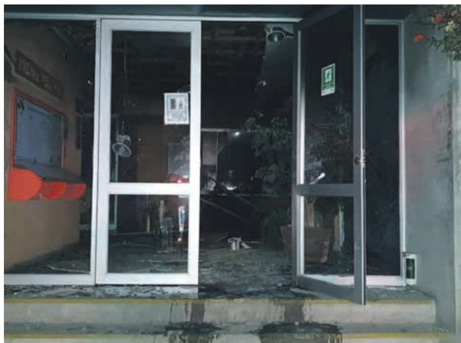
La explosión dañó por completo la estructura de la dependencia de la Universidad Católica del Norte, donde estaba ubicado el cajero automático.
