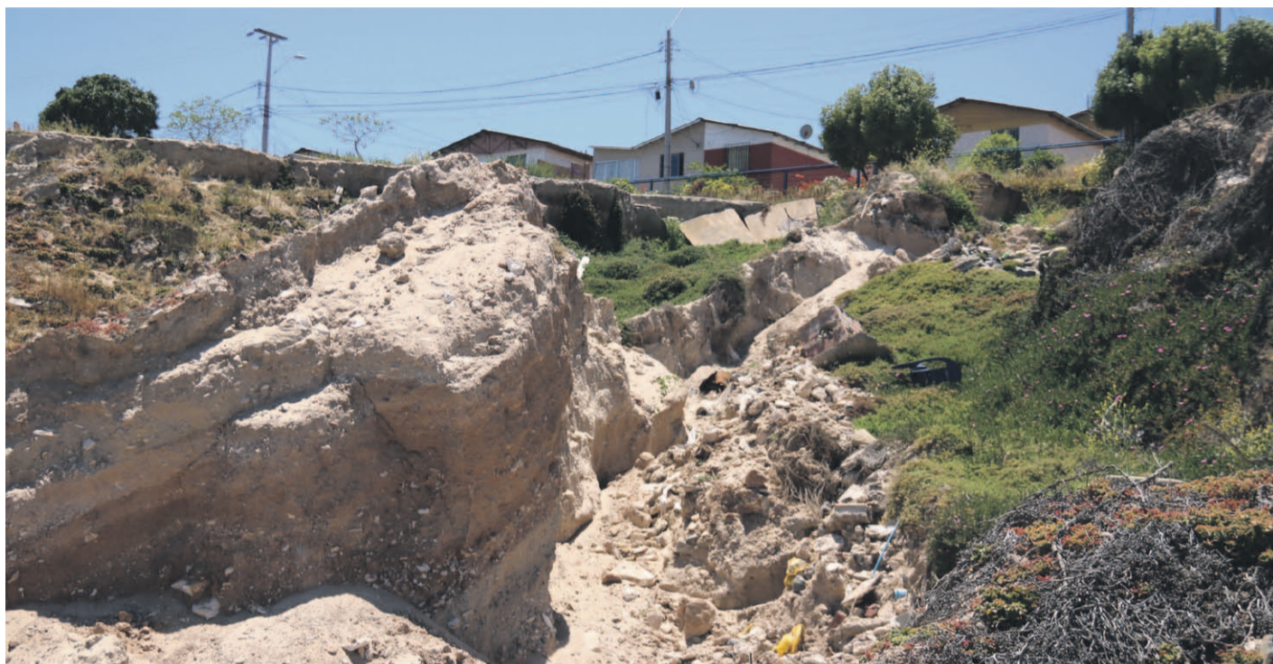
Los vecinos de Villa Talinay han visto como, lo que era una hermosa plaza, se fue cayendo poco a poco, transformándose en un verdadero peligro.
