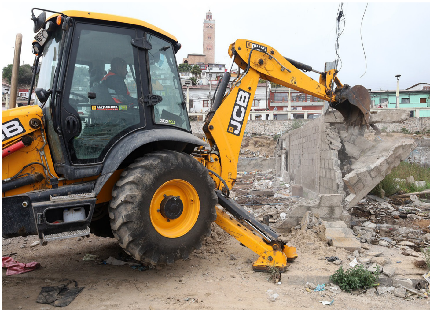
Con maquinaria pesada se inició el proceso de demolición y limpieza del sector Baquedano en Coquimbo.
