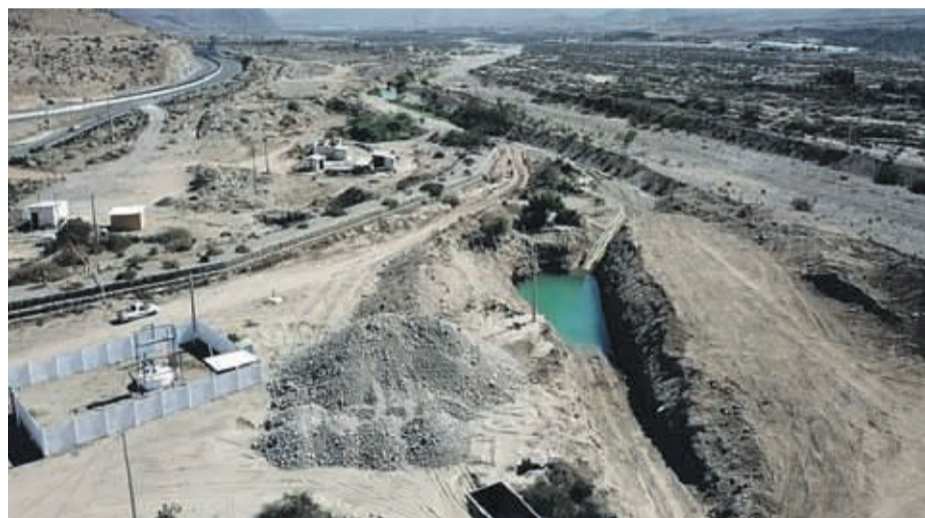
En la imagen se observa el lugar en donde se está construyendo la nueva noria que alimentará el alcantarillado de La Higuera (derecha), la cual se encuentra llena de agua. A la izquierda en tanto, se observa el pozo actual del APR de la localidad.
