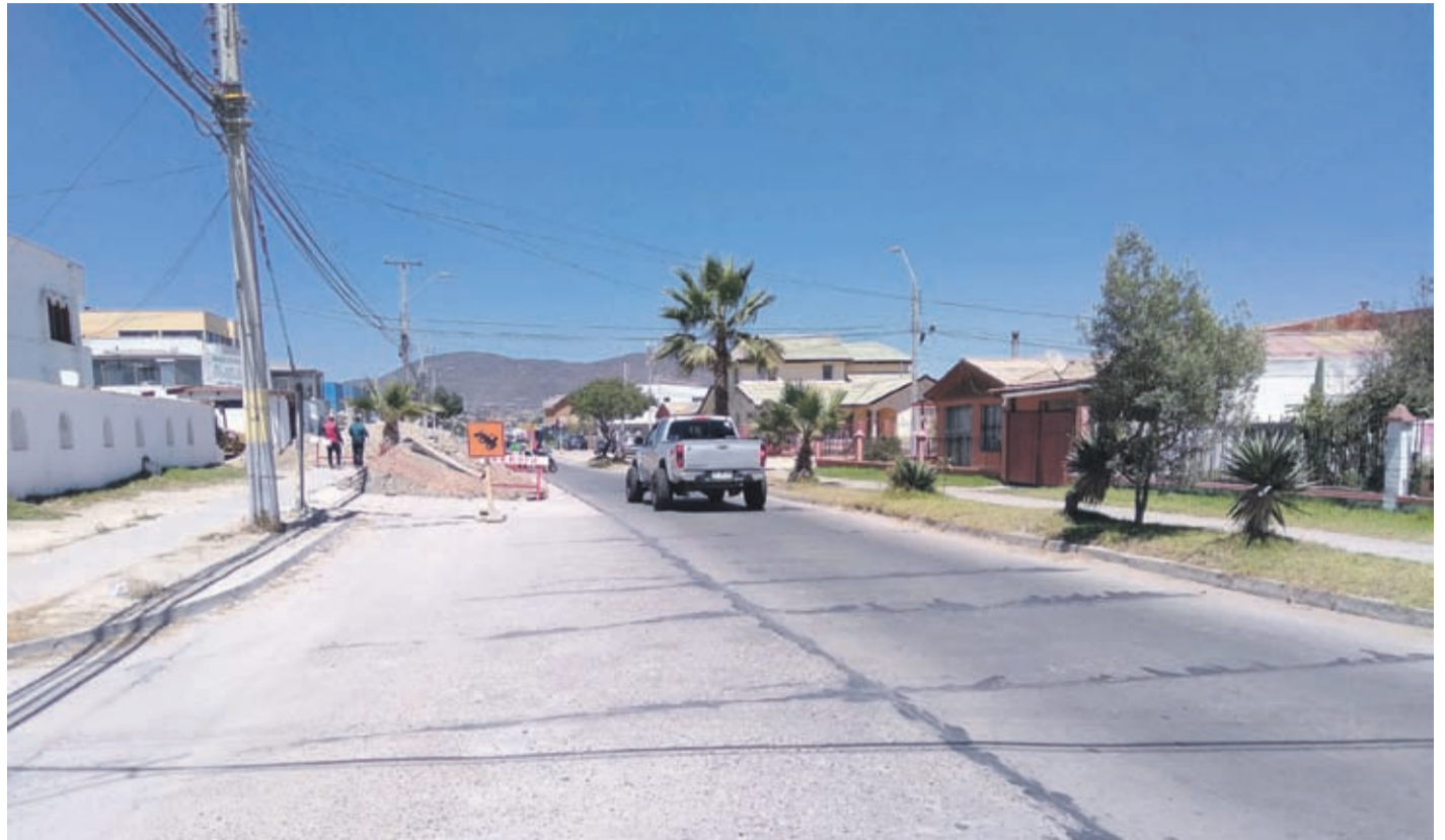
En calle Las Azucenas el colector bajo tierra colapsa y las aguas servidas rebalsan las cámaras de desagüe de algunas viviendas, situación que complica a los residentes.
