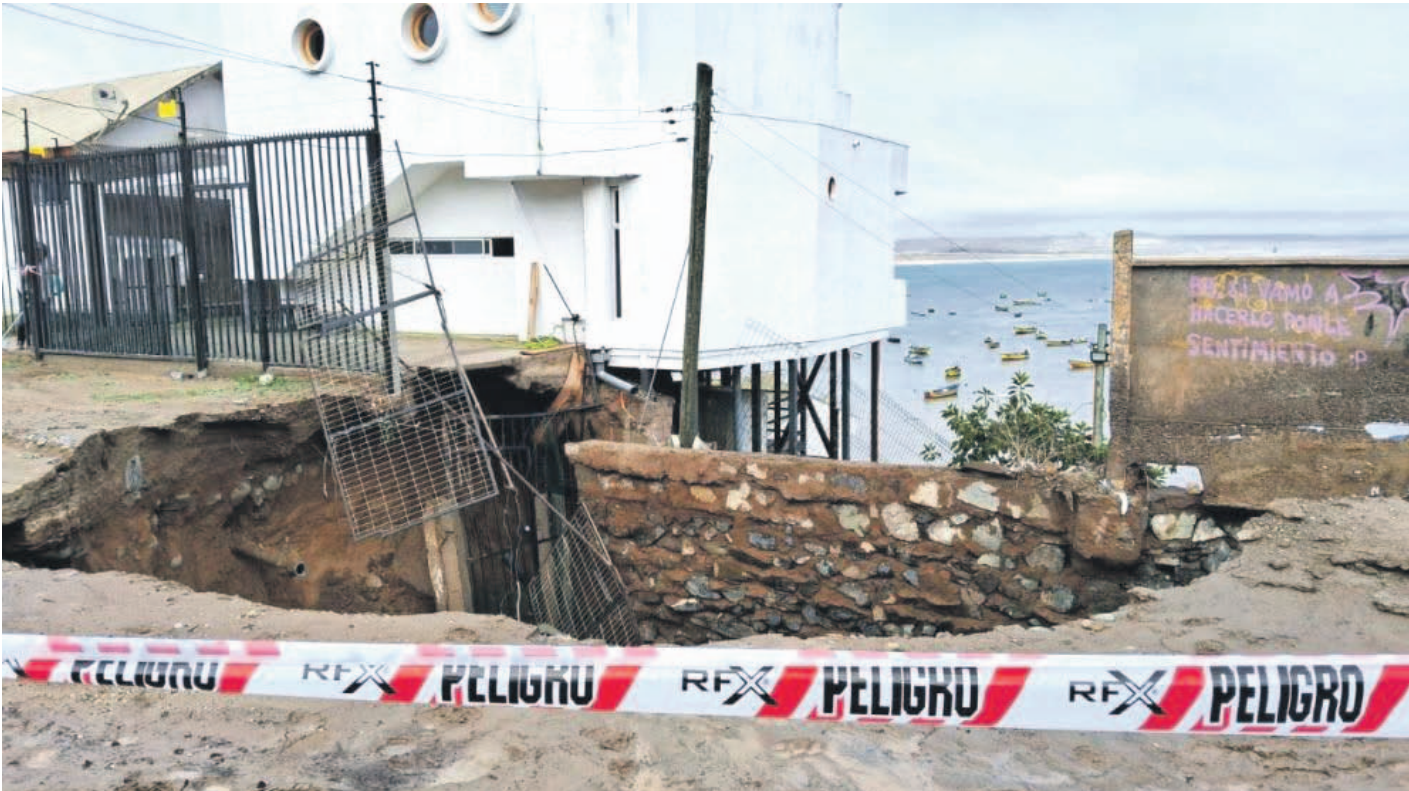
Las últimas lluvias dejaron una gran socavón frente a una vivienda de veraneo en Tongoy.
