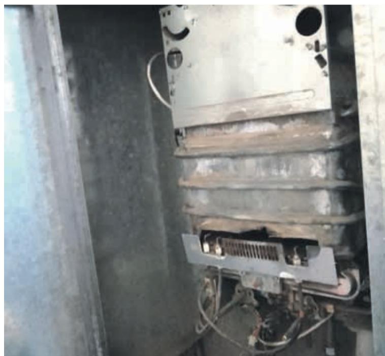
Daño en el calefón de una de las viviendas de la población Ariztía. Así como ésta, hay evidencias de filtraciones de agua y otros desperfectos eléctricos.
