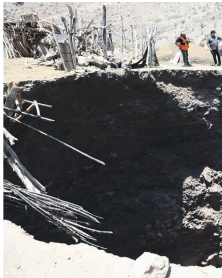
El socavón de unos 15 metros de diámetro y 18 de profundidad continúa creciendo sin medidas de mitigación. FOTO EL DÍA
