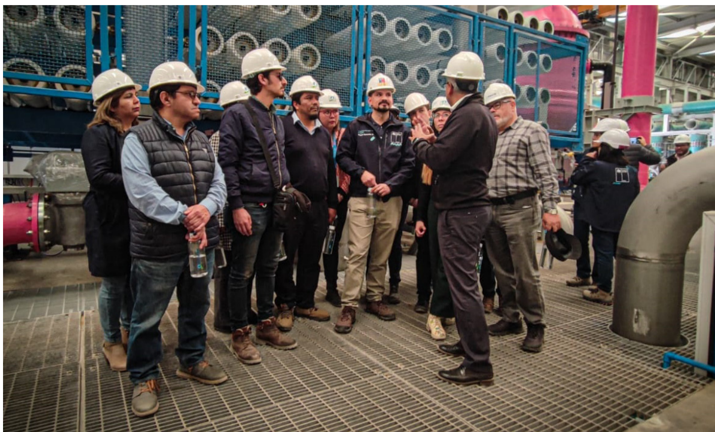
Liderados por el delegado Rubén Quezada, las autoridades regionales recibieron una detallada charla del funcionamiento de la planta desaladora de Caldera.
