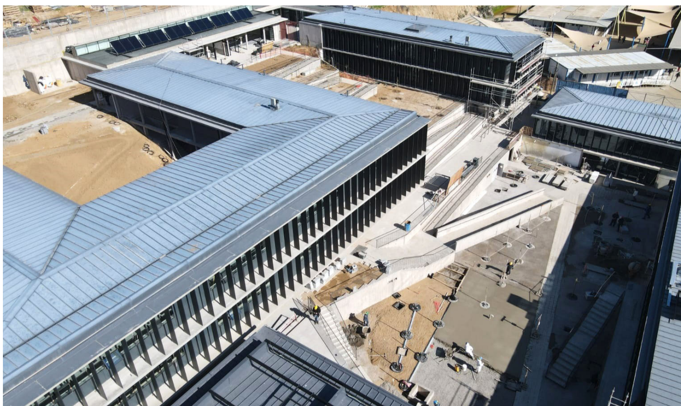
Las obras de la escuela estarían finalizadas dentro de los próximos meses.
