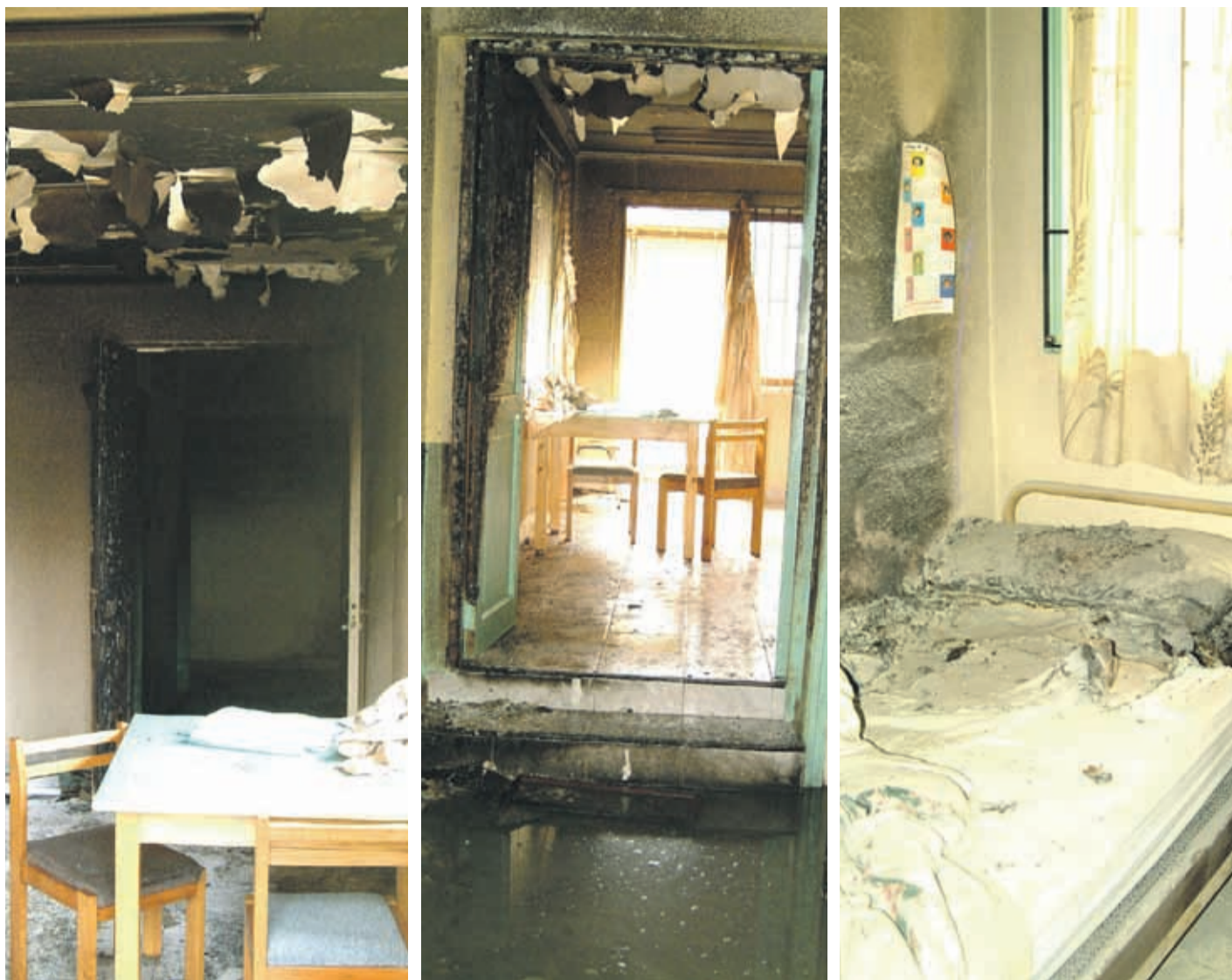
En las tres imágenes se pueden ver los daños que dejó el incendio que provocó el autor del ataque en el lugar de residencia de las monjas. La tercera fotografía (derecha) corresponde a la pieza de la hermana Lita Castillo.
