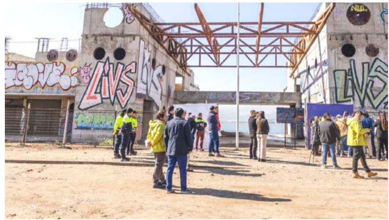
Las obras del Mercado del Mar en Coquimbo se encuentran paralizadas desde hace 7 años. EL DÍA
