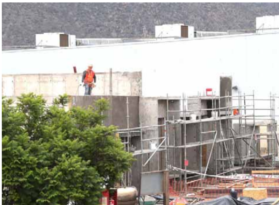
Imagen de la construcción del Centro Edudown de hace unos meses. Hoy, las obras físicas presentan un 100% de avance.
