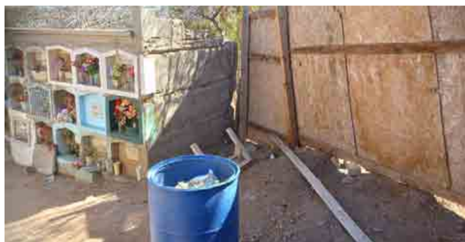
Una de las denuncias de la comunidad es el deterioro del cementerio de Punitaqui.
