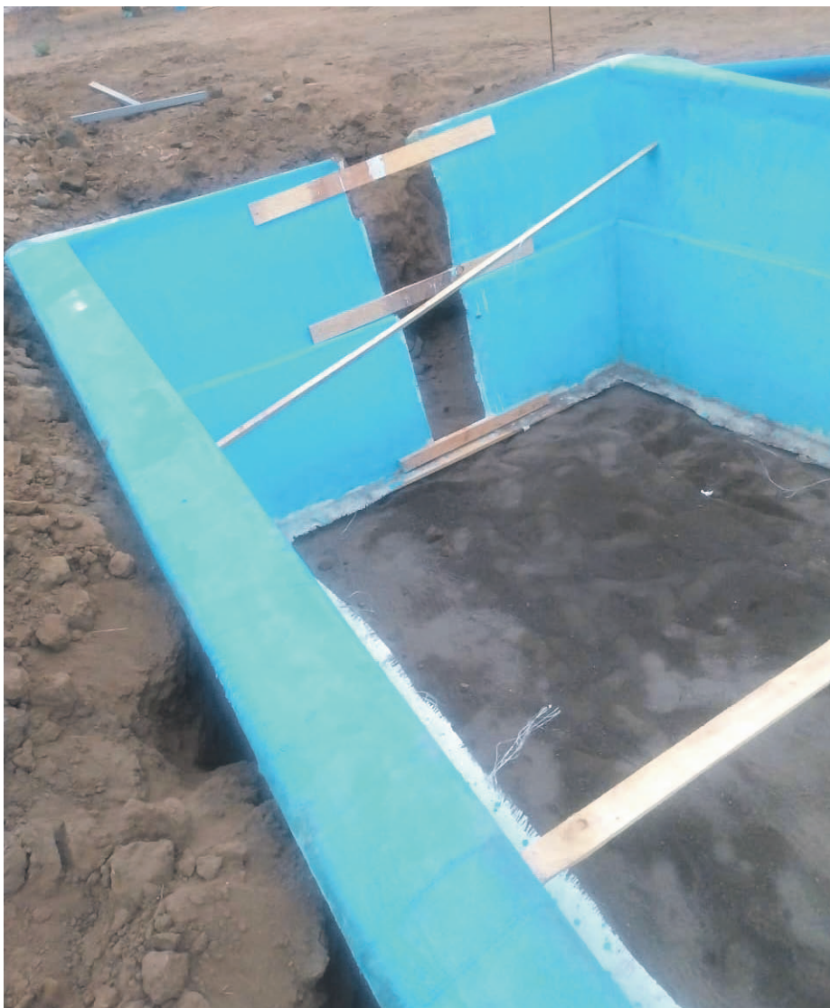
Imagen del estado actual de una de las obras “abandonadas”.
