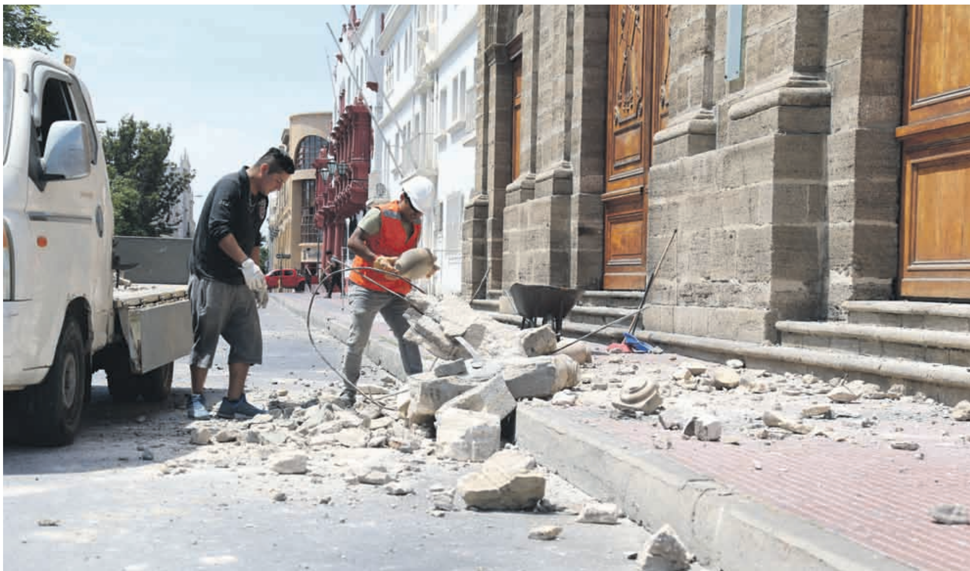
El emblemático edificio de la Catedral resultó seriamente dañado por el violento movimiento.
