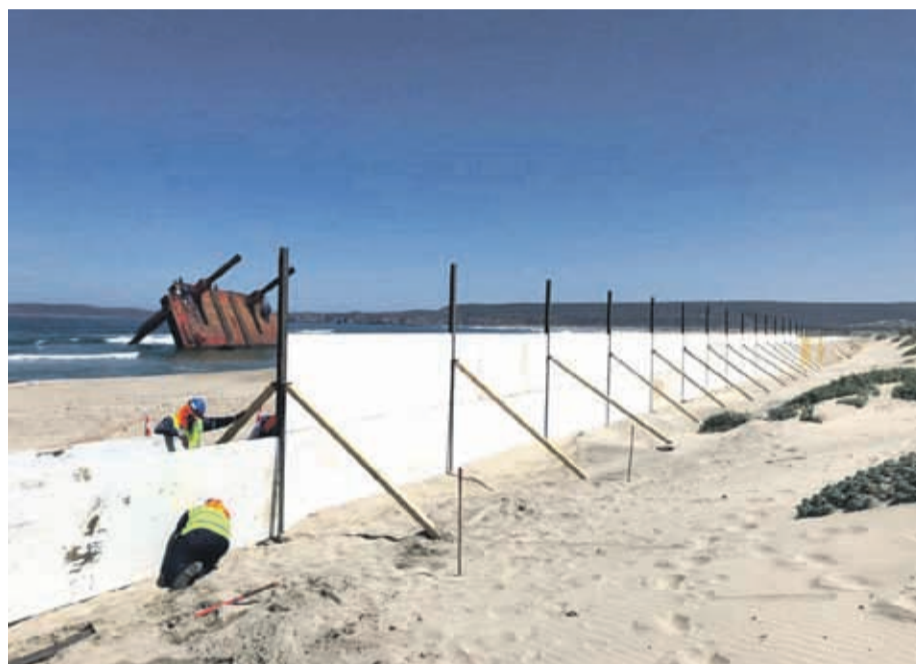
Durante estos días Minera Los Pelambres ya ha comenzado con los primeros trabajos de mitigación previo a la remoción de la plataforma marítima.
