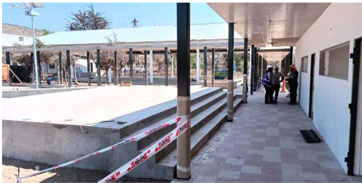
La escuela de Barraza es una de las obras paralizadas en la Provincia del Limarí.
