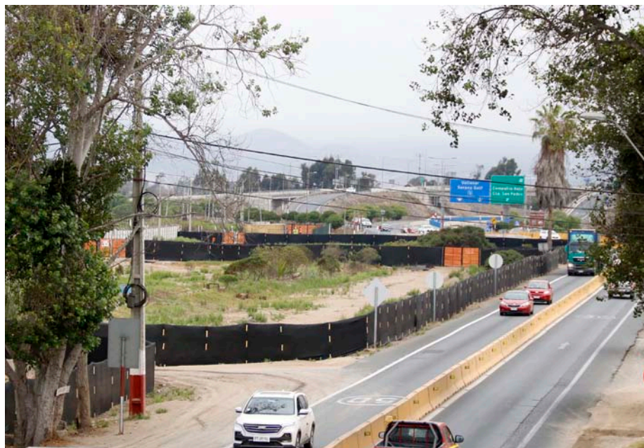
En 2016 se paralizaron las obras frente al sitio El Olivar, dejando sólo una pista habilitada en la entrada norte de la ciudad de La Serena.
