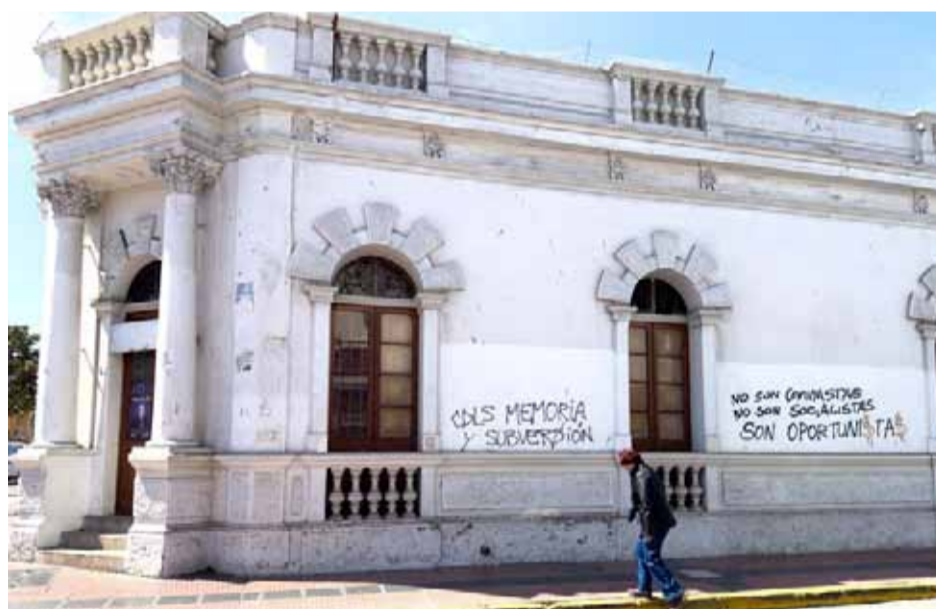
Muros rayados, techos en mal estado y fachadas deterioradas abundan en el centro de la capital regional.
