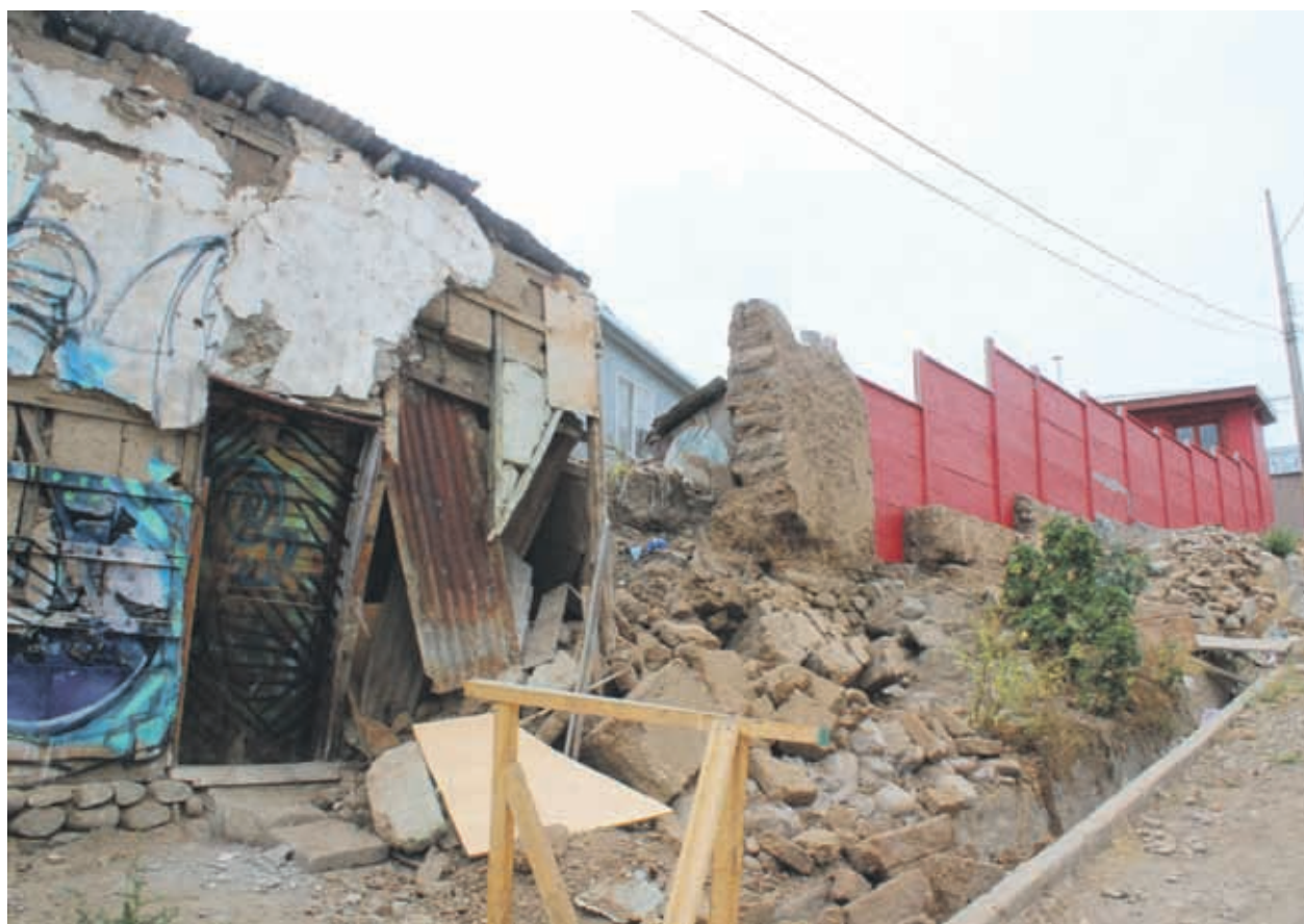
Paredes de adobe derribadas y grietas en varias construcciones es el panorama en el casco histórico de La Serena.
