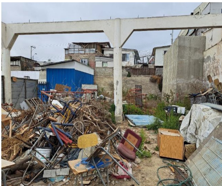
Uno de los establecimientos que tuvo más irregularidades fue el colegio Claudio Arrau en Coquimbo, en el cual, se encontraron escombros y daños estructurales.
