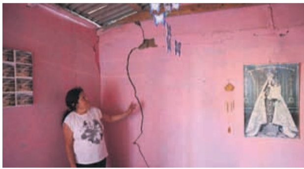
Las viviendas de adobe de Quebrada de Talca resultaron con daños en su interior. En la imagen, Susana Zepeda muestra la enorme grieta en uno de sus muros que la hace pensar en abandonar su hogar por el miedo.
