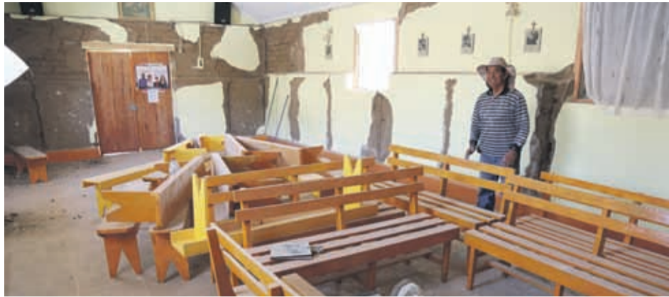
La iglesia de Quebrada de Talca quedó con serias fisuras al interior y es la familia Rojo la que se encarga de restaurarla por su propia cuenta.
