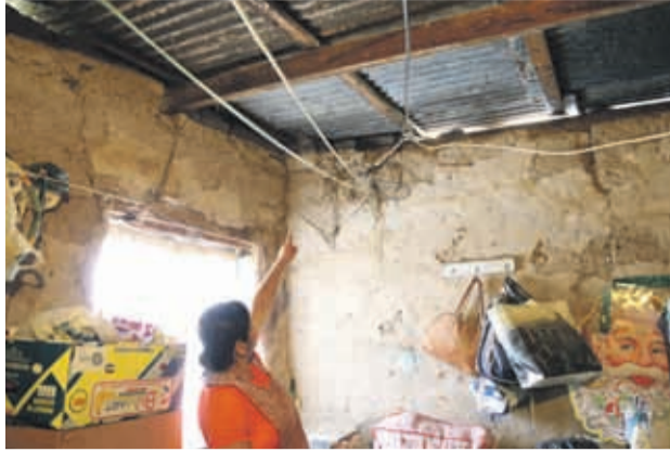
En Marquesa , comuna de Vicuña, hay familias que temen continuar en sus viviendas por temor a que se derrumben totalmente. En la imagen, Marisol Vigorena muestra los daños en su casa.
