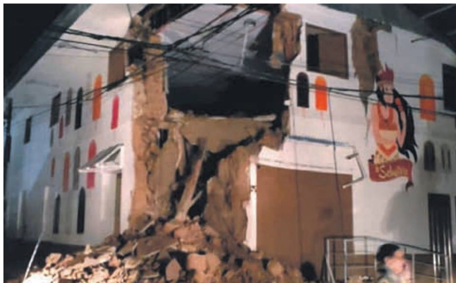
Captura de la cuenta de Twitter @bomberosPE que muestra los daños ocasionados tras un sismo en un edificio de la calle Mariscal Castilla de Yurimaguas, Perú
