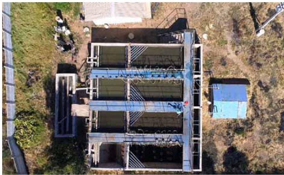
En 2018 se inauguró en la comuna de Ovalle la primera planta de reúso de aguas residuales tratadas para uso productivo en el país.
