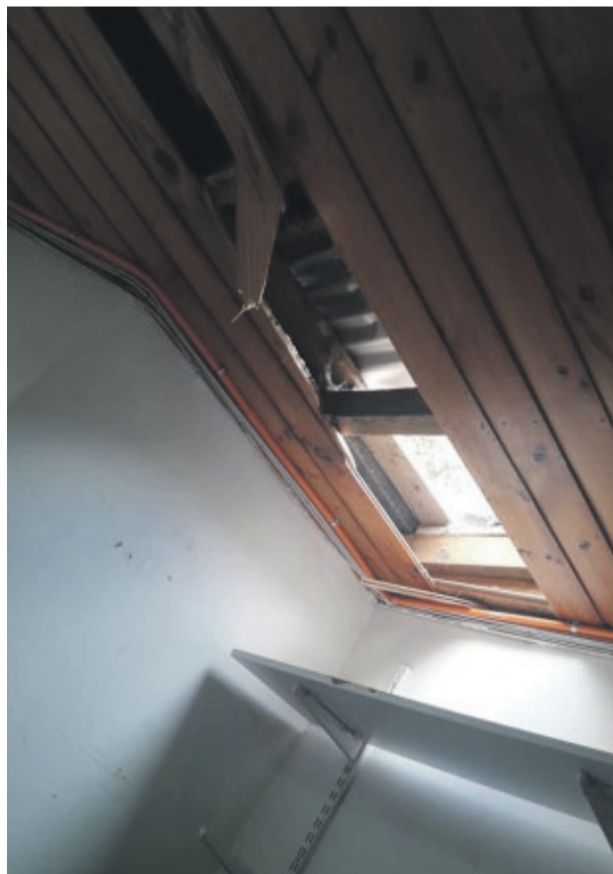
Falta evaluar los daños y destrozos en la casa, porque hay pérdidas más allá de lo que se robaron. ELOVALLINO
