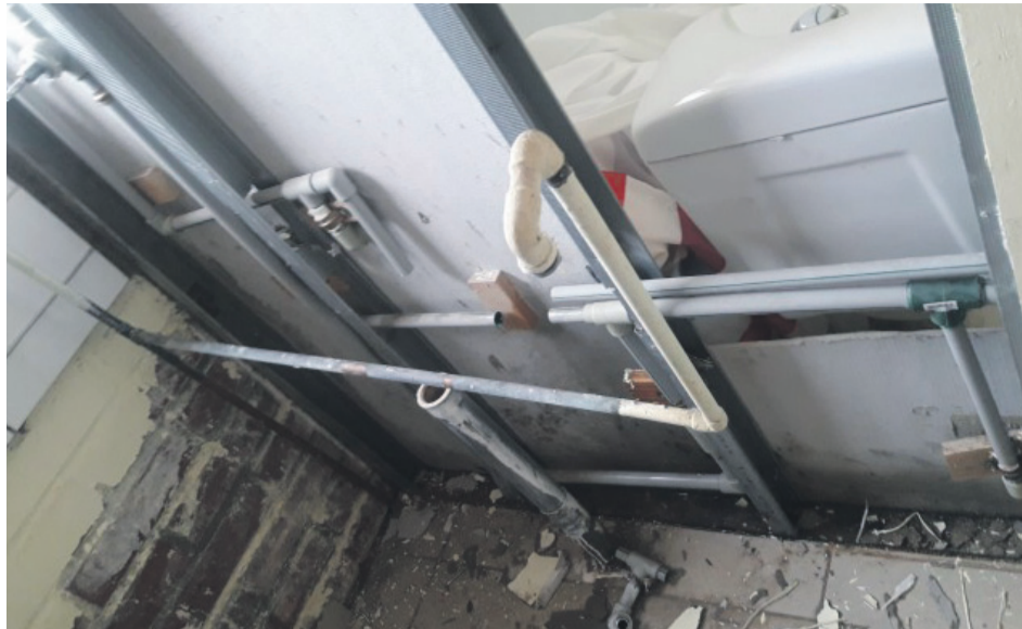
Los trabajos en las cañerías han sido una incomodidad para los vecinos, que en varios casos han tenido que correr con esos gastos.
