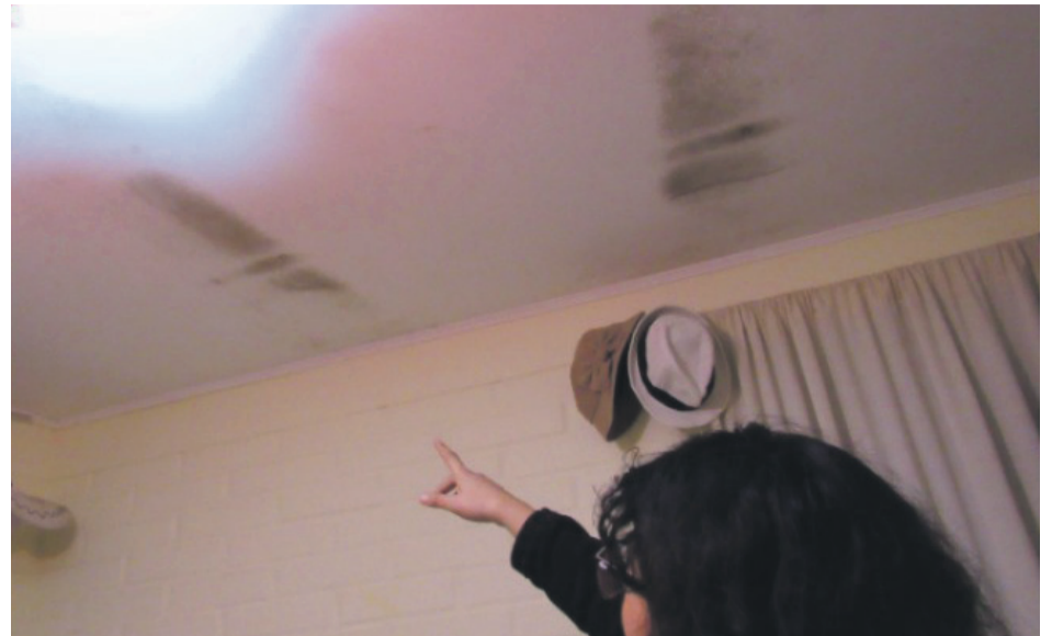
Las filtraciones y la humedad han sido la tónica en los techos de las diferentes viviendas de Los Torreones. Eso sigue preocupando de cara al invierno.
